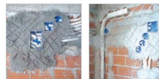
ΕΓΚΑΤΑΣΤΑΣΗ ΣΥΣΤΗΜΑΤΩΝ ΣΩΛΗΝΩΝ ΧΩΝΕΥΤΟΥ ΤΥΠΟΥ
